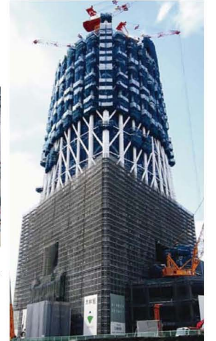
写真2 熟練溶接技能者が活躍した建設中の「東京スカイツリー」
