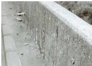
中性化による劣化
