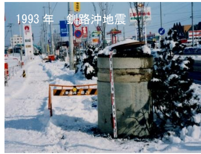
b)鉧路市マンホールの浮上 写真1：液状化被害の事例
