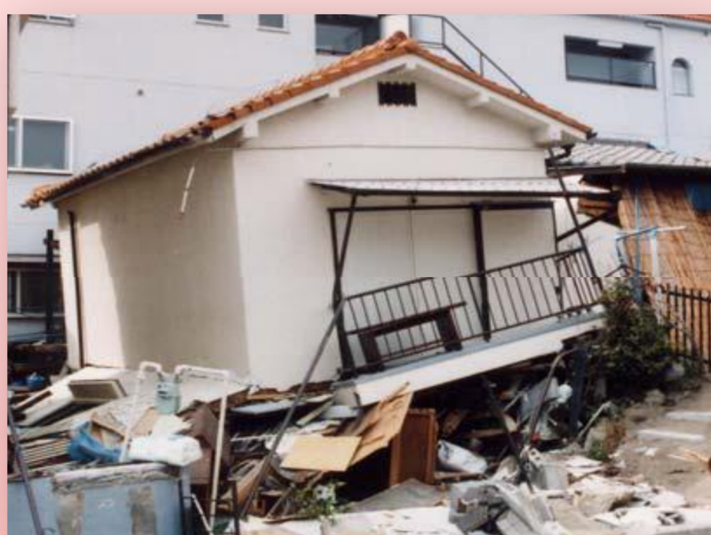
ねじれ崩壊した建物 (平面的な剛性バランス)
