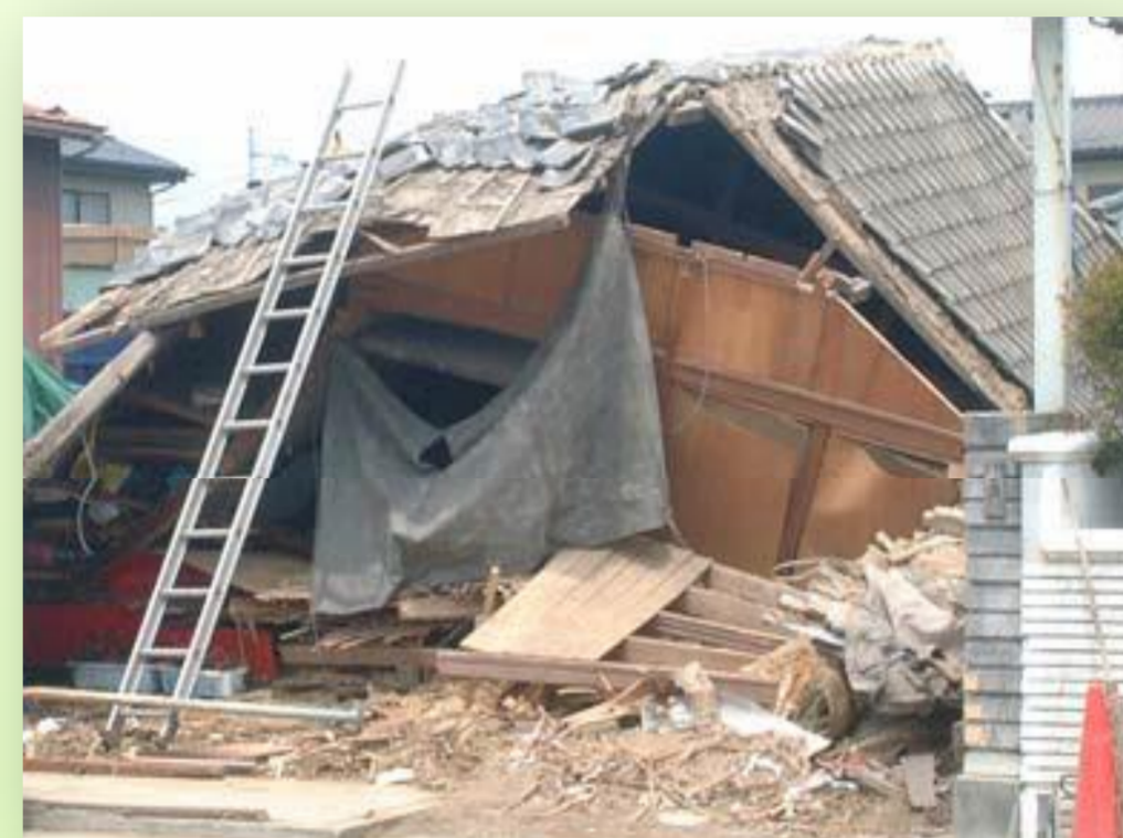
圧壊した建物 (屋根など重い場合)
