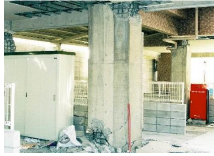
(b) 柱頭・柱脚の曲げ圧壊
