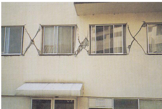
短柱のせん断破壊
