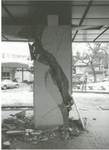
ピロティー部における 長柱のせん断破壊
