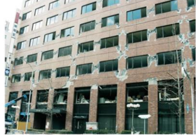
曲げ圧壊とせん断破壊の混在
