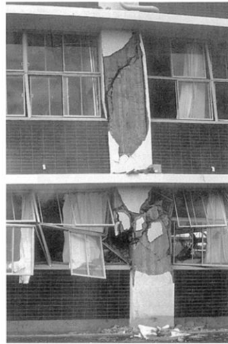
学校建築における 短柱のせん断破壊
