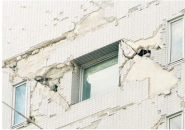
典型的な短柱のせん断破壊
