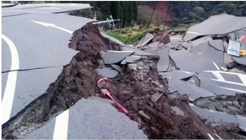
2016年4月熊本地震の被害
