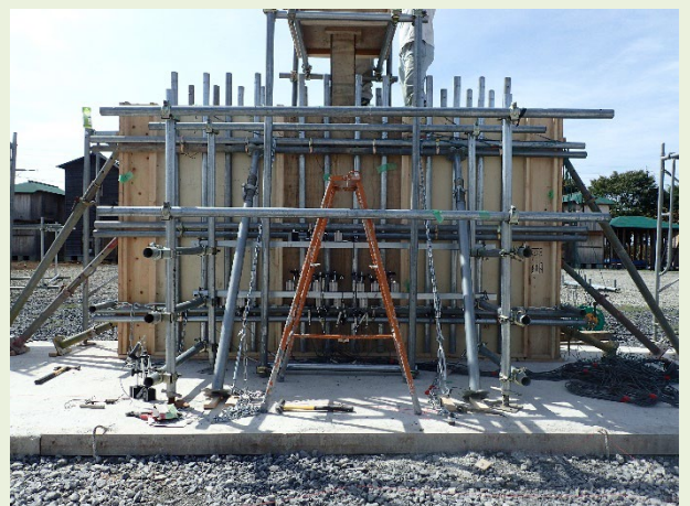
実大レベルの試験体でコンクリートの側圧と型枠の変形量を計測
