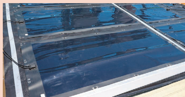
ペロブスカイト太陽電池は次世代太陽電池の本命と目される(都内における設置実証) 『深層断面 JSME EDITION』より
